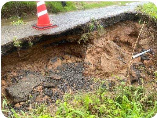
行戸地内 路肩崩落
