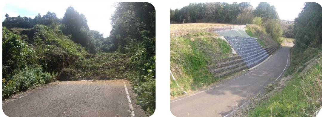
小幡地内の地すべり（左）災害発生時（右）復旧後
