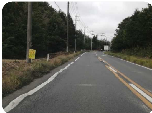
道路の歪み、劣化(三和地内)
