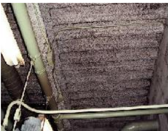
石綿含有吹付けロックウール
