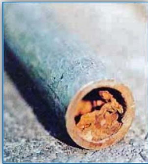
水道管 錆コブ
