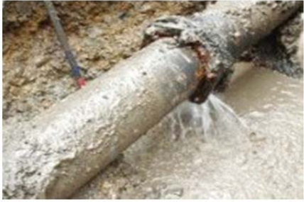
铸铁管の漏水
