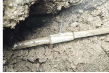
TS 形塩化ビニル管の漏水
