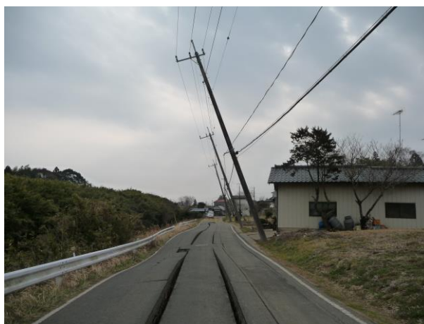
▲市道のひび割れと傾いた電柱
