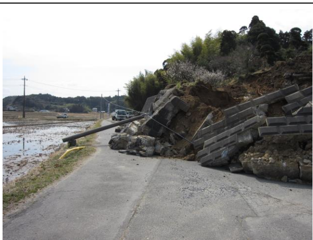
▲崩落した擁(よう)壁
