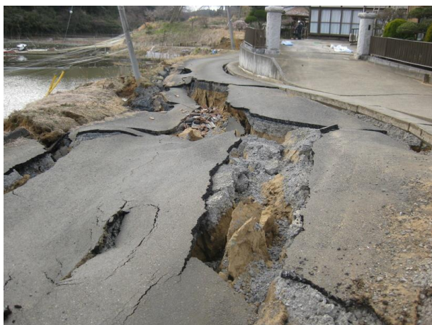
▲崩落した市道
