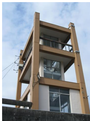
▲柱が圧壊した市役所庁舎(解体済)
