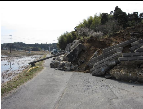
▲崩落した擁(よう)壁
