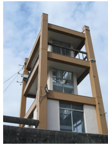
▲柱が圧壊した市役所庁舎(解体済)
