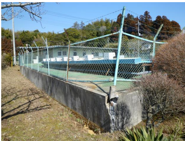
▲地盤沈下により土台がずれたプール
