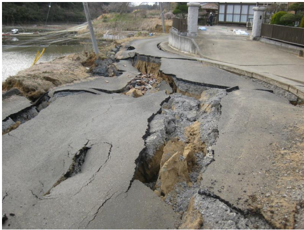
▲崩落した市道
