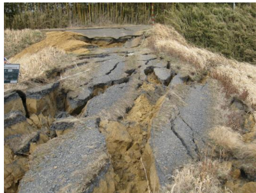
▲ 東日本大震災における市内道路の崩壊状況
