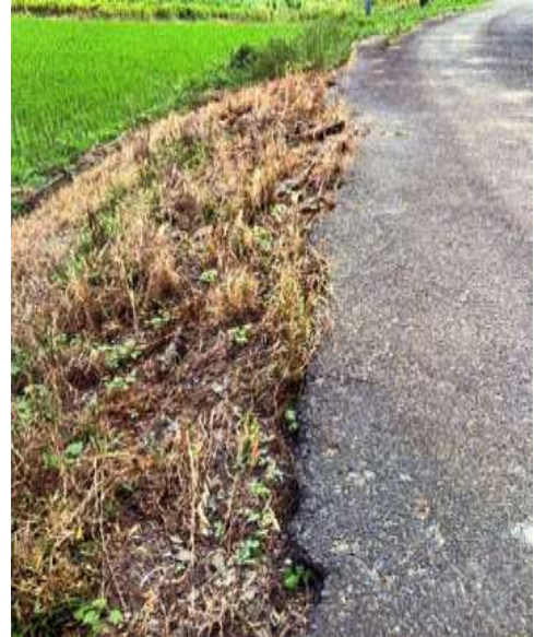
【農薬を散布された道路法面の状況】
