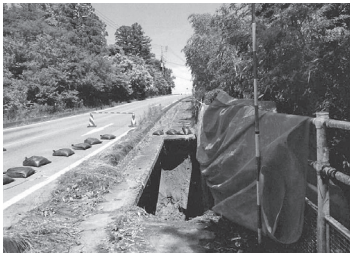
大雨により陥没した路面 (芹沢地内)
