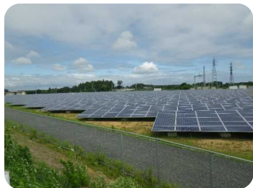
北浦複合団地太陽光発電所
