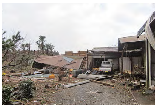
平成30年3月に発生した突風被害
