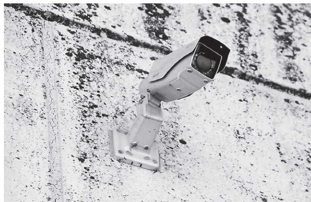
教育施設整備事業 防犯カメラ設置工事 (28,026,000 円) 〔設置された防犯カメラ〕
