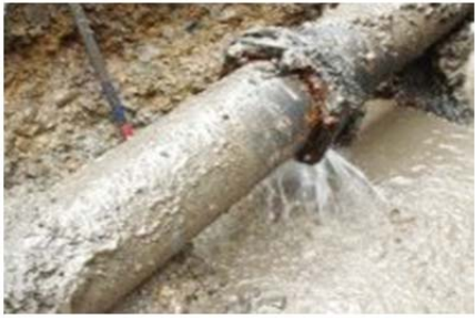
铸铁管の漏水
