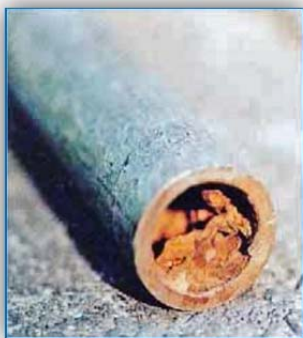
水道管 錆コブ
