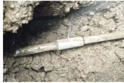
TS 形塩化ビニル管の漏水
