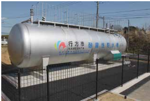
飲料水兼用耐震性貯水槽（玉造中）
