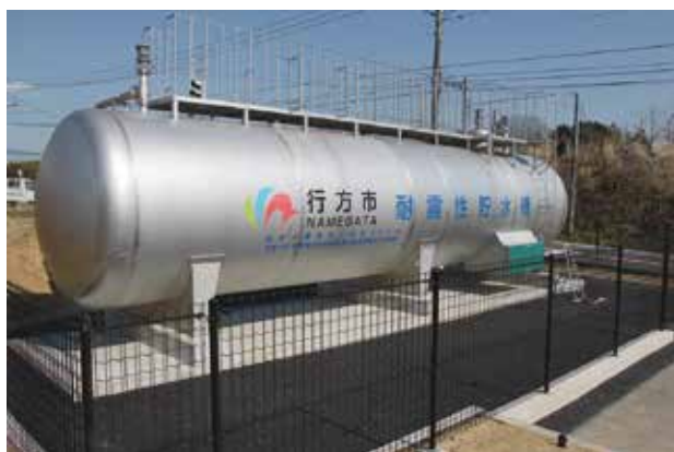
飲料水兼用耐震性貯水槽（玉造中）
