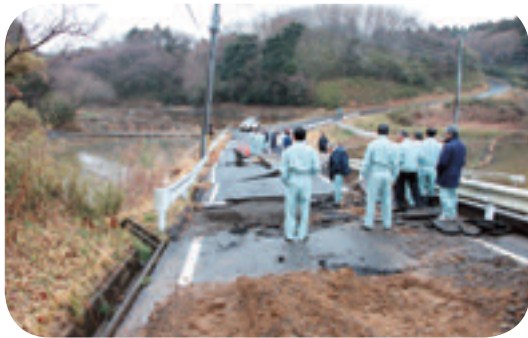
議会として被害現場を確認しました
