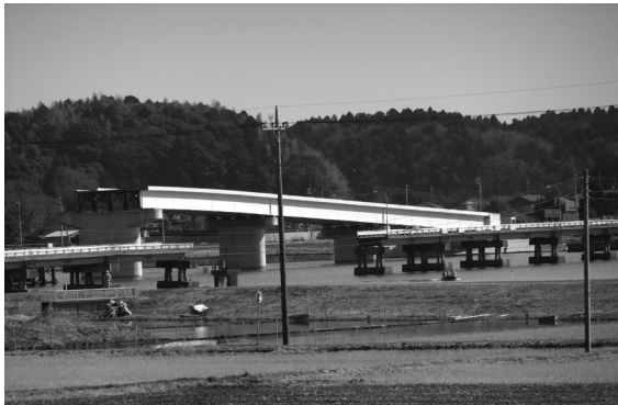
▲鹿行大橋が崩落
