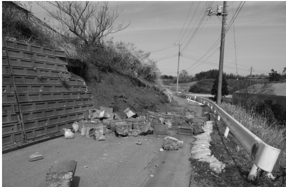
▲落石と破損したガードレール
