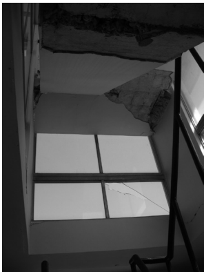
▲庁舎の天井が崩落
