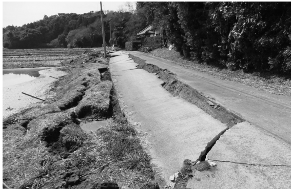
▲陥没した道路
