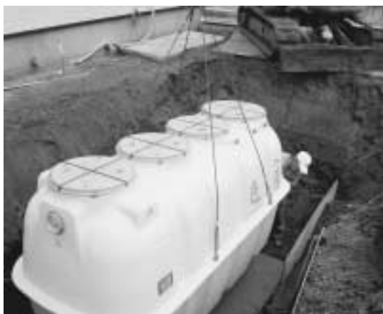
高度処理型浄化槽の設置には市の補助があります
