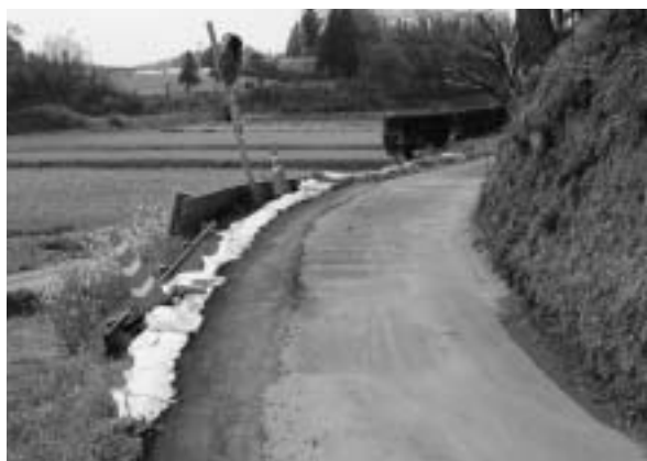
維持補修による安全管理に努めます（繕沢）
