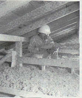
断熱材：屋根裏に吹きつけているものは、古紙を繊維状にほぐしたものです。断熱性はもちろん、防音性にも優れていると評判です。
