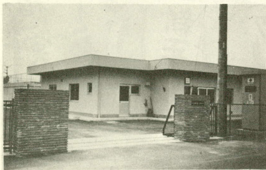
簡易水道浄水場
