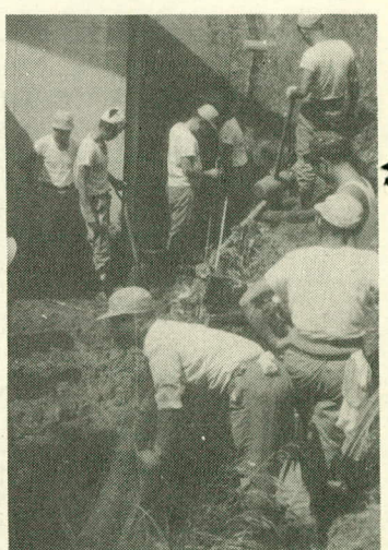
台風25号で大和幼稚園の崖がくずれた。この時は稲もだいぶたおされたが、父兄の協力で早い復旧作業ができた。
