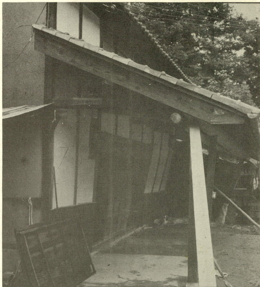
裏山の土砂くずれで半壊した住居兼物置(於下)
