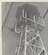
とりつけられたサイレン(宿地区)
